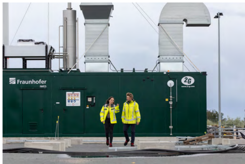
Das Blockheizkraftwerk ist Teil der Forschungsanlage.
